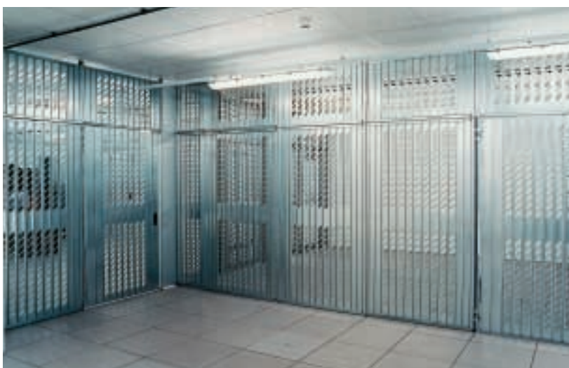
Cages in hochmodernen Rechenzentren.
