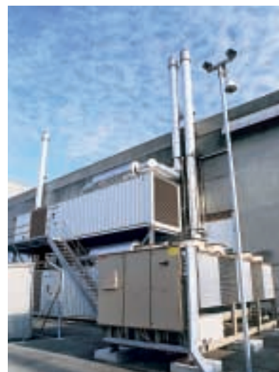
Kaltwassersatz und neuste Dieselgeneratoren
